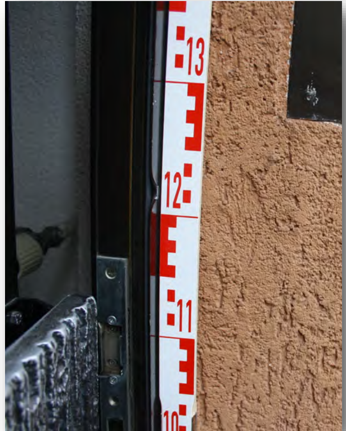
Hier sind am Türrahmen deutlich die Hebelspuren des Einbruchversuchs zu erkennen.
