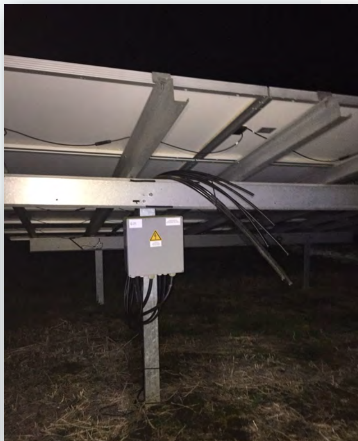
Die abgetrennte Kupferverkabelung der Solarpaneele wurde im Ausland verkauft.
