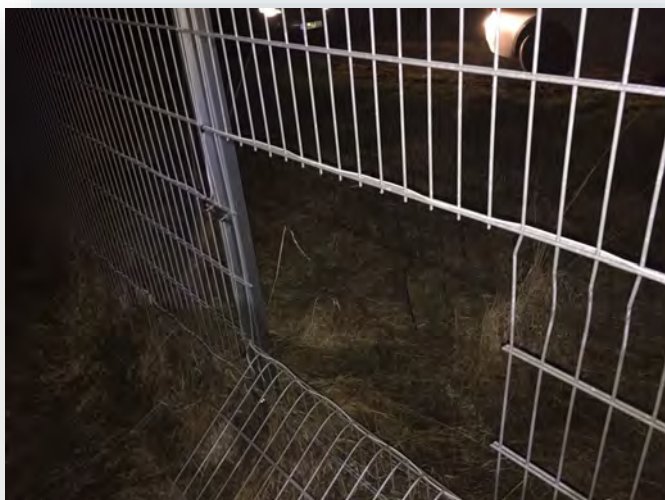
Die Täter schnitten Löcher in die Umzäunung und gelangten so auf das Gelände.
